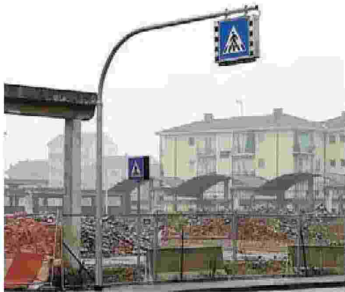
Le macerie dell'ex stabilimento in via Adam
